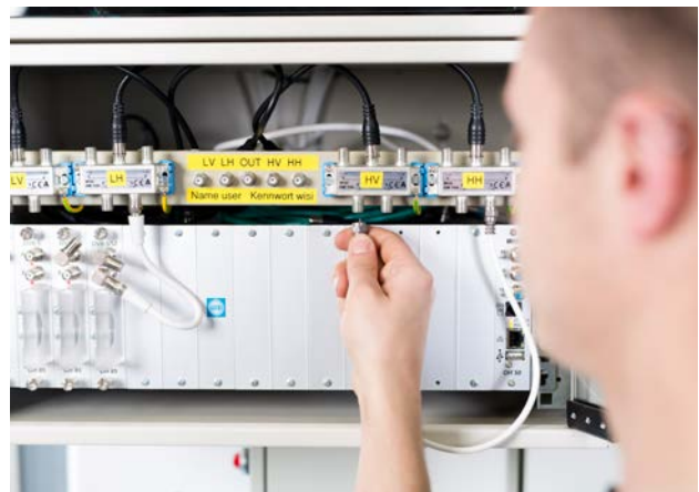
Abbildung 2: Kopfstation einer Satellitenanlage (Quelle: ZVEH)
