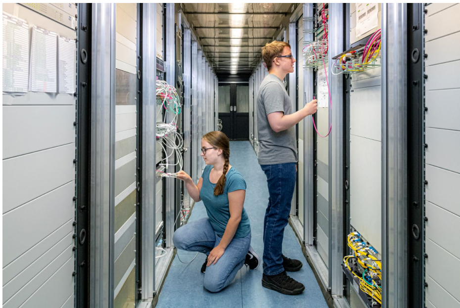
Abbildung 21: Vernetzen von Serversystemen (Quelle: Deutschlandradio/Bengsch)
