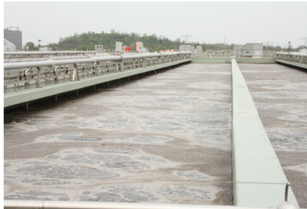
Abb.: Belebtschlammanlage Klärwerk Waßmannsdorf / Berlin. Paust-Lassen
