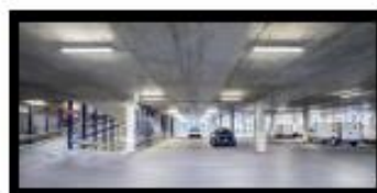
Beleuchtung des Parkhauses
