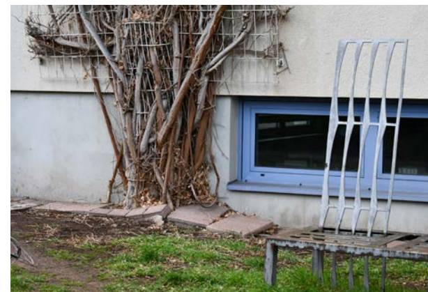
Abb. 15: Kontrolle der Pflanzfläche auf Wurzelschäden. Quelle: BuGG
