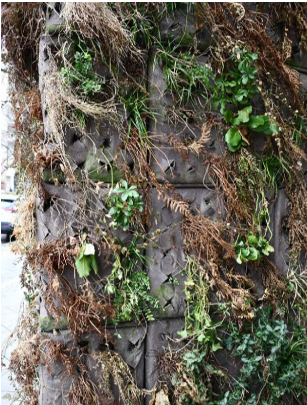
Abb. 40: Regelmässige Kontrollen des Begrünungssystems und das Erkennen von Schäden verhindern den Totalausfall der Begrünung. Quelle: BuGG
