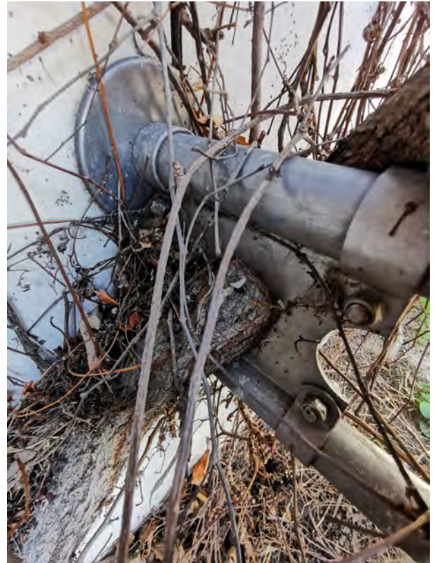
Abb. 77: Der zu geringe Abstand der scharfkantigen Halterung zur Wand kann den Pflanzenstamm beschädigen. Quelle: BuGG
