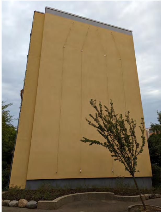
Abb. 80: Nach der Sanierung des Gebäudes wurde die Kletterhilfe montiert, jedoch keine Kletterpflanzen eingesetzt. Quelle: BuGG
