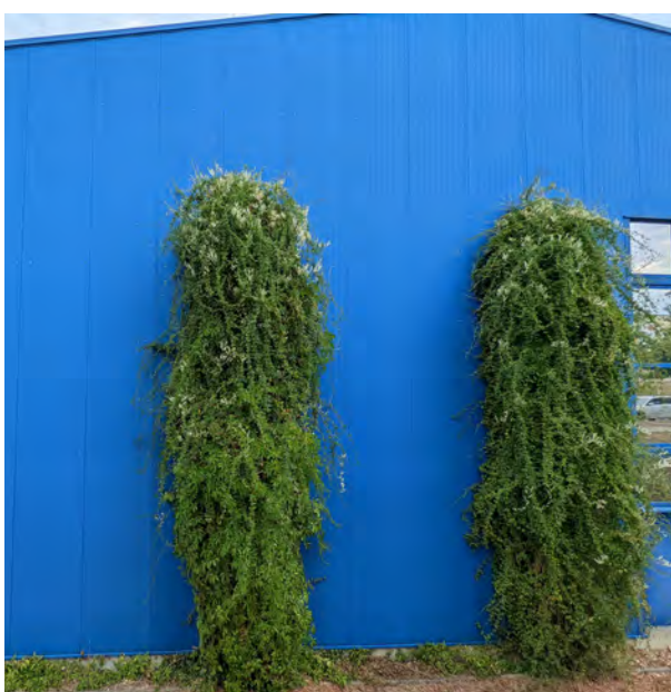
Abb. 183: Gerüstkletterpflanze ( Fallopia baldschuanica ) an Metallfassade. Quelle: BuGG
