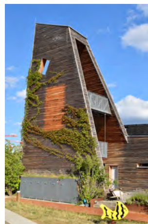
Abb. 200: Selbstklimmer sind an Holzfassaden zu vermeiden. Quelle: BuGG
