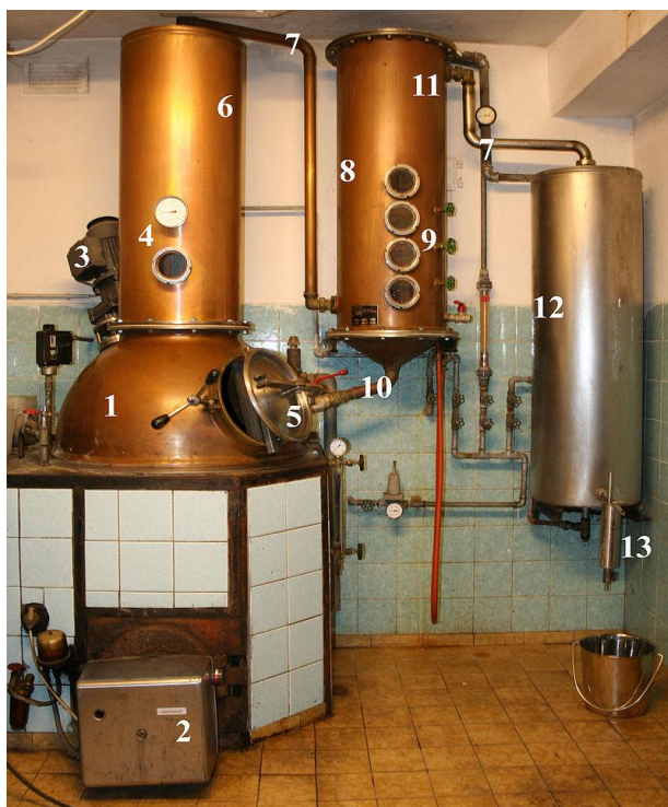
Abb. 100: Schnapsbrennanlage zur Destillation der gärenden Rohmasse (Brennanlage für Abfindungsbrennerei;
