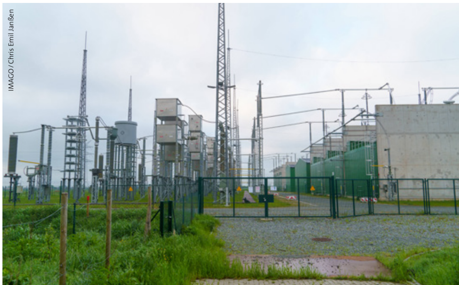
Ende Mai 2021 wurde die NordLink-Stromtrasse zwischen Norwegen und Deutschland offiziell eröffnet. Zukünftig fließt überschüssiger Strom aus deutschen Windenergie-Anlagen nach Norwegen zum Endverbrauch, während Deutschland bei Bedarf mit Strom aus norwegischen Wasserkraftwerken versorgt werden kann. Die Konverterstation in Wilster in Schleswig-Holstein bildet den Abschlusspunkt der Trasse.
