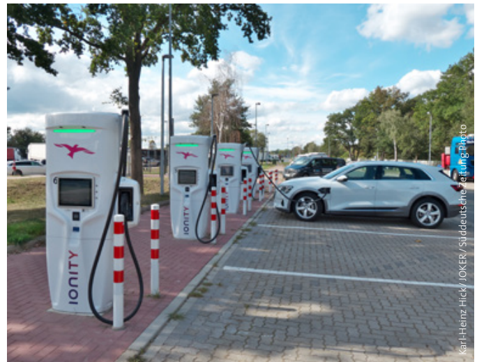
Staatliche Förderprogramme zielen auch auf ein emissionsärmeres Verkehrsverhalten. Ein konsequenter Ausbau des Ladetzes soll Elektromobilität langstreckentauglich machen. Ladesäulen an einer Autobahnraststätte auf der A2, 2020
